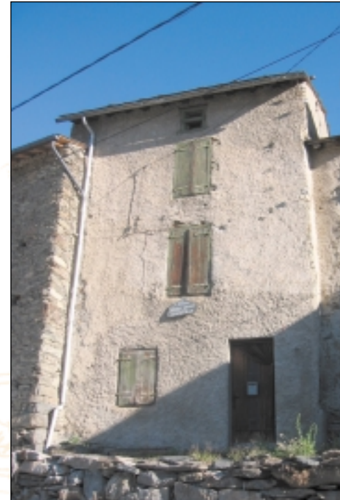
Enduit d'origine à la chaux qui ne met pas en péril les qualités d'imperméabilité du mur et peut donc être conservé.
