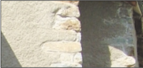
Type d'enduit à éviter qui tend à faire apparaître systématiquement toutes les pierres d'angles au prix parfois d'un disgracieux "bourrelet" d'enduit.
